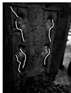
图5-c 混凝土开裂及整体破坏
