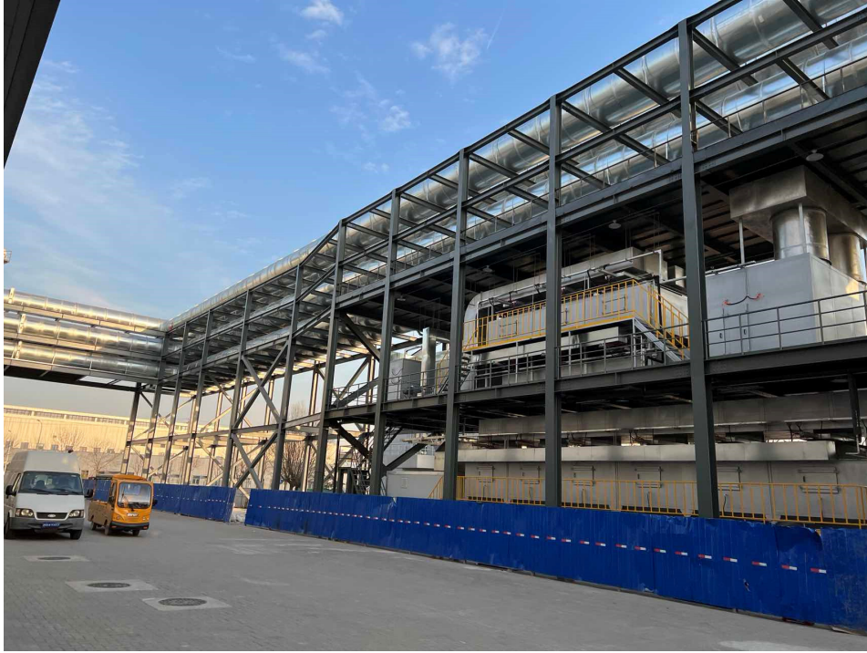
图 9.2-3 本项目废气净化装置外观实物图
