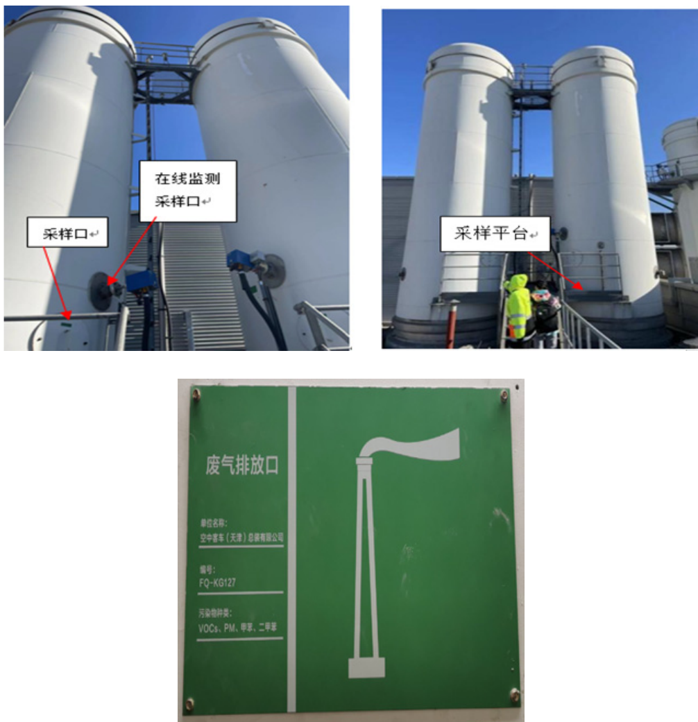
图 3.6-2 DA001-1、DA001-2 排气筒及标识
